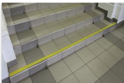
Контрастная маркировка ступеней лестничного марша
